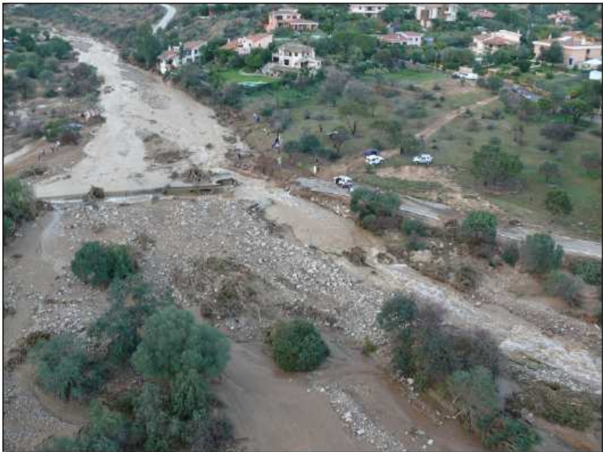
Il ponte della strada comunale di Poggio dei Pini crollato dopo l'evento di piena dell'ottobre 2008 (vista da valle verso monte)
